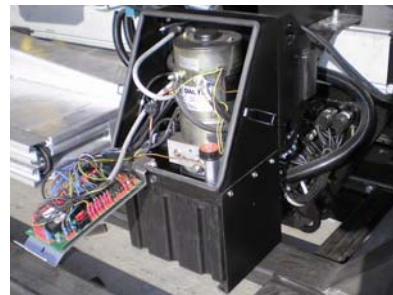
Servicefreundliches Antriebsaggregat und Steuerung
